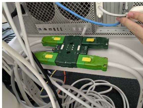
図 11: AC 部屋サーバールームに設置されたジョイントボックス
