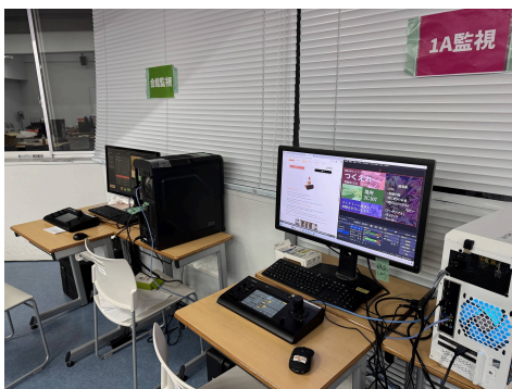
図 5: 1A ステージ・会館ステージ(PTZカメラ)の操作卓
