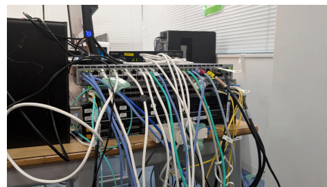
図 6: 本部に設置されたインフラ設備
